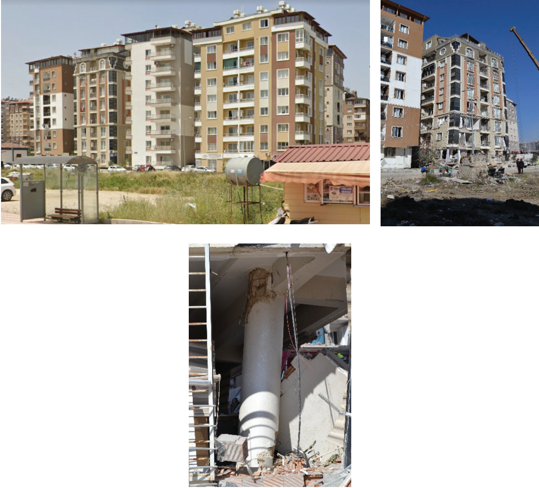
Şekil 5. Ağır hasar alan binada köşe kolon durumu
