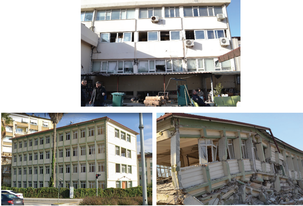
Şekil 17. Kısa kolon oluşumu ve hasarı
