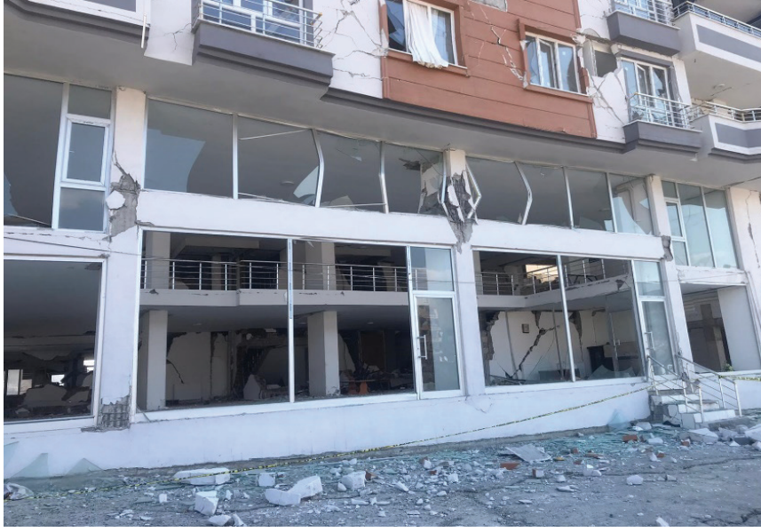
Şekil 16. Bina cephesinde kısa kolon oluşumu
