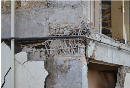
Şekil 15. Farklı kotta bağlanan kirişlerden dolayı hasar
