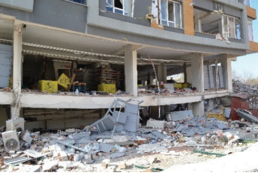
Şekil 3. Cephe konsola mesnetlenen kiriş tasarımı ve hasar
