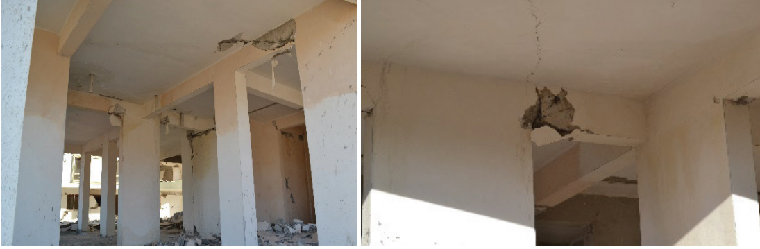
Şekil 6. Çok yakın kolon tasarımı ve kısa kirişte kesme hasarı
