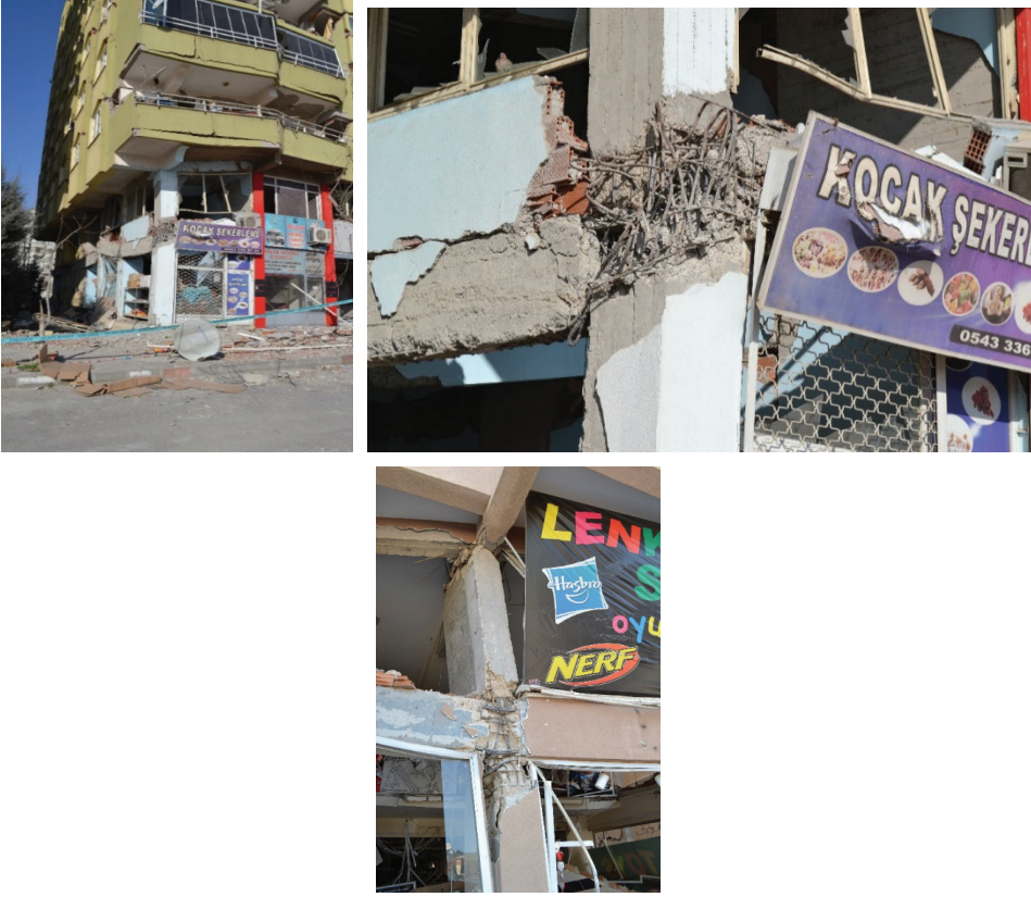
Şekil 14. Zemin katı dükkan olarak kullanılan ve asma katlı binalarda hasar
