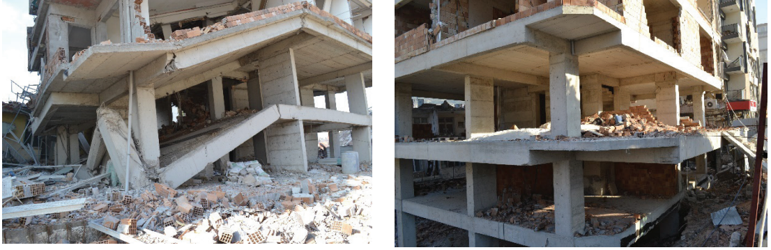
Şekil 1. 1999 öncesi yapılmış binalarda taşıyıcı sistem durumu ve kiriş süreksizliği örneği
