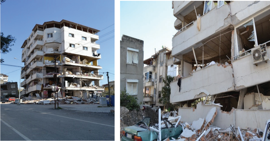
Şekil 7. Taşıyıcı sistemde sürekli kiriş oluşturulmaması ve meydana gelen hasar.
