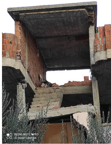
Şekil 18. Merdiven sahanlığı nedeniyle kısa kolon oluşumu
