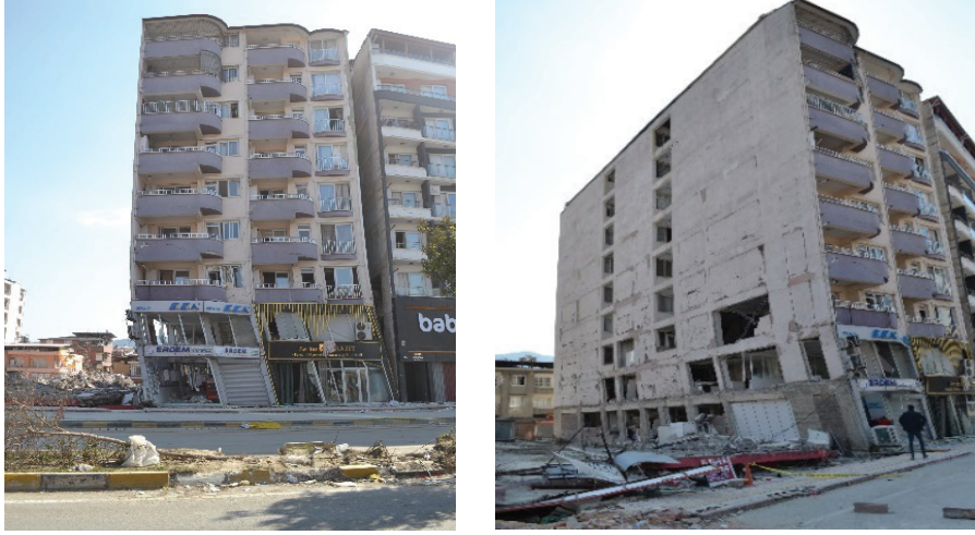
Şekil 8. Yumuşak kat oluşumu
