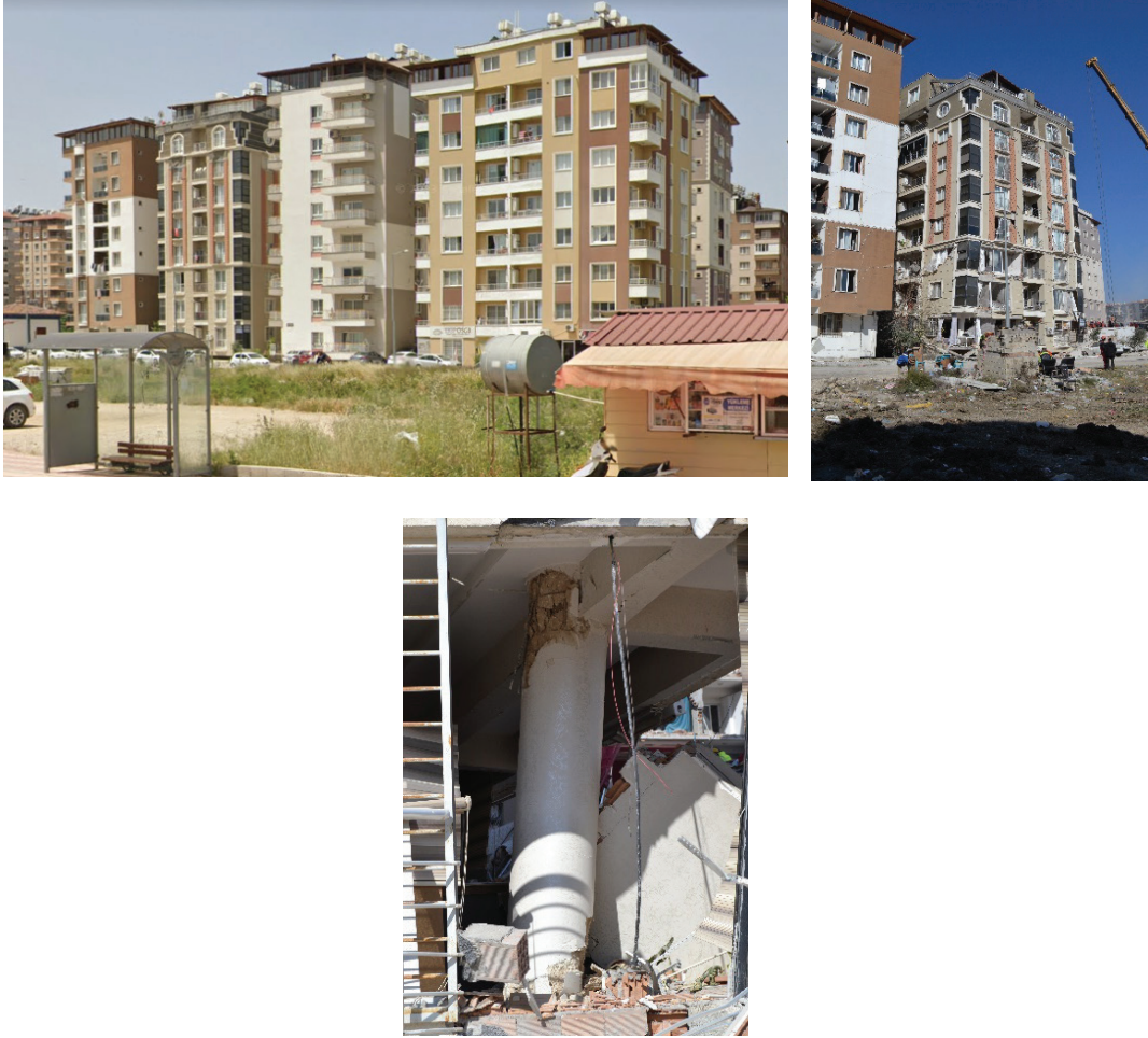
Şekil 5. Ağır hasar alan binada köşe kolon durumu
